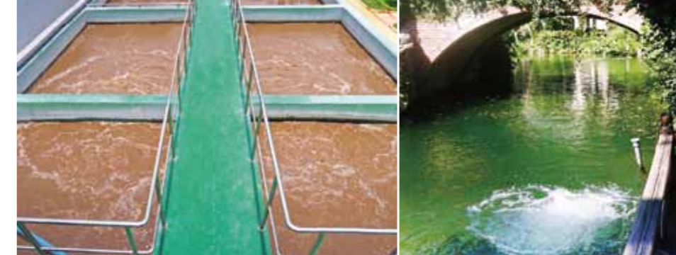
▶ การบำบัดน้ำเสีย : ติดตั้งที่ความลึก 4.5 เมตร
